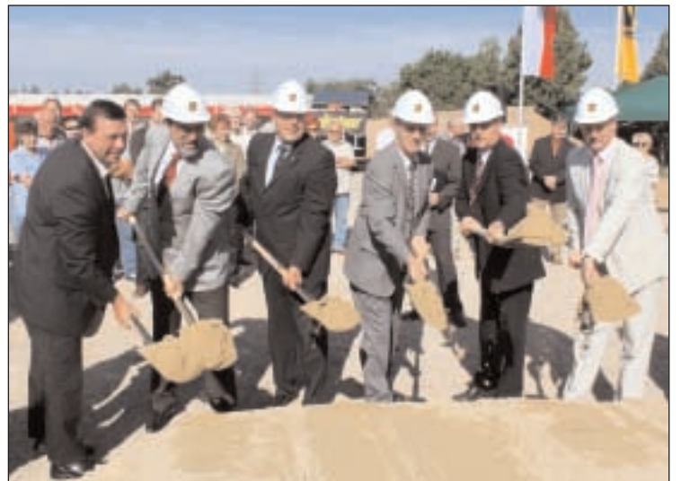
Am 09. September 2009 erfolgte in Gößnitz der erste Spatenstich zum Neubau der Bundesstraße B 93 Ortsumgehung Gößnitz. Der Bau der 5,7 Kilometer langen Trasse wird Gößnitz wesentlich vom Durchgangsverkehr entlasten und kostet rund 30,8 Millionen Euro. Die neue Ortsumgehung umfasst sieben Brückenbauwerke und gliedert sich in drei Abschnitte. Südlich von Gößnitz beginnt die neue Strecke, die östlich an Gößnitz und Löhmitz vorbeiführt und nördlich von Löhmitz wieder in die bestehende B 93 übergeht. Fertigstellung ist für 2012 geplant.
