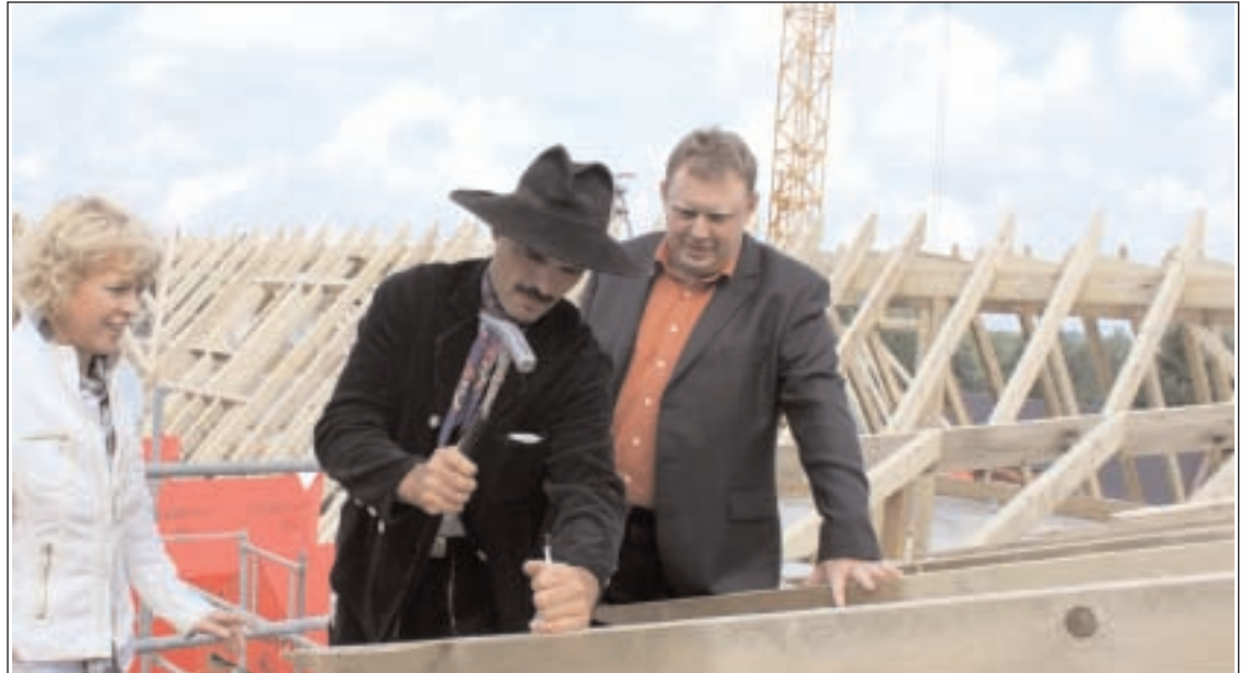
Zimmermann Uwe Langheinrich (Bildmitte) schlägt gemeinsam mit den beiden Geschäftsführern Gabriele Matzulla und Tilo Knoblauch den letzten Nagel in den Dachstuhl Fotos: SiMa
