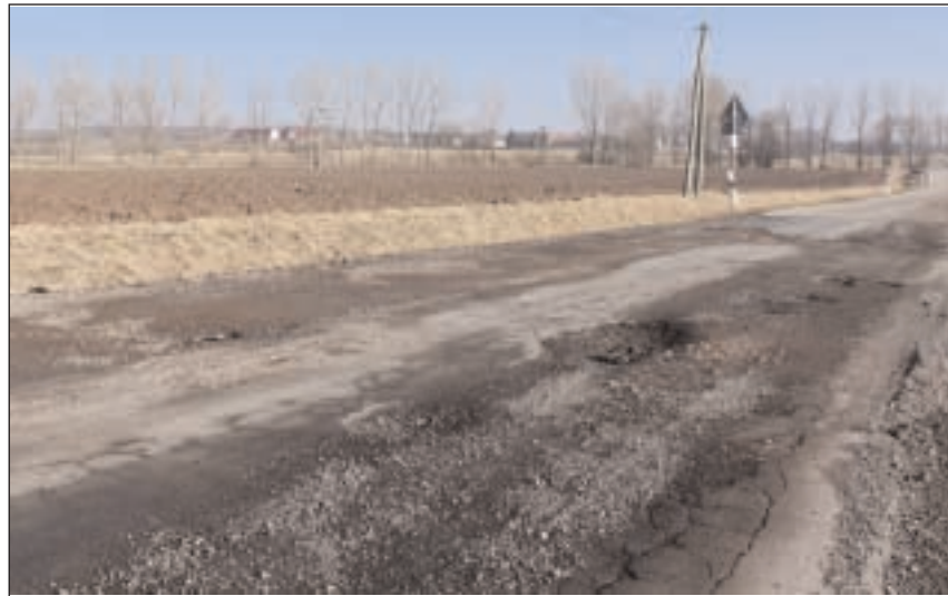
Schäden auf der Straße zwischen Kraschwitz und Bocka
