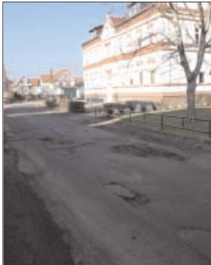
Straßenschäden in der Ortslage Großstörnitz
