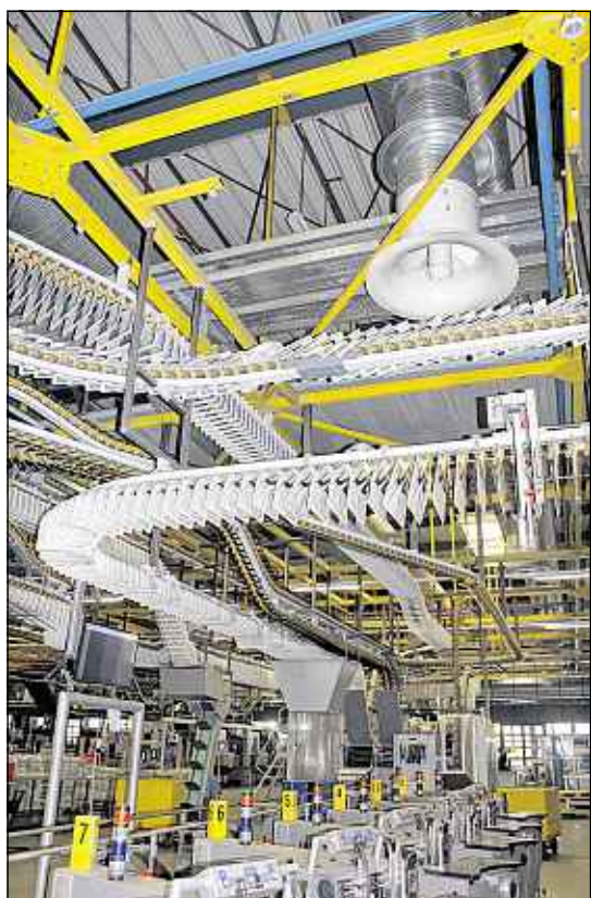
Auf über den Köpfen der Mitarbeiter schwebenden Transportbändern gelangen die frisch gedruckten Zeitungen von der Druckmaschine zur Pack- und Auslieferstation.
