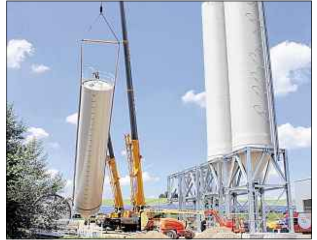
Im Sommer wurden die 28 Meter hohen Silos von zwei Kränen in Position gebracht
