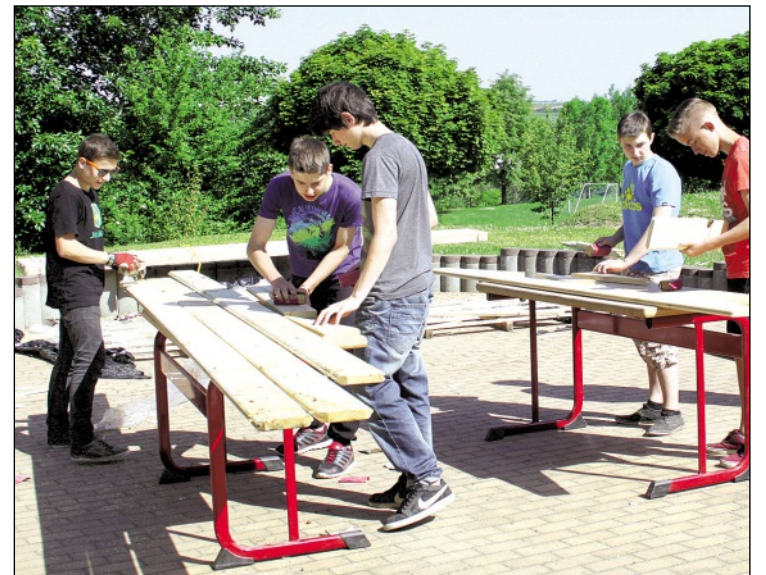
Schüler der Regelschule Nöbdenitz bauen für ihr Schulgelände eine Hütte, in der Freizeitgeräte untergebracht werden sollen
