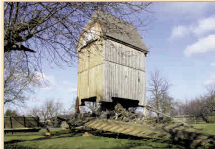
Die abmontierten Flügel der Bockwindmühle in Lumpzig
