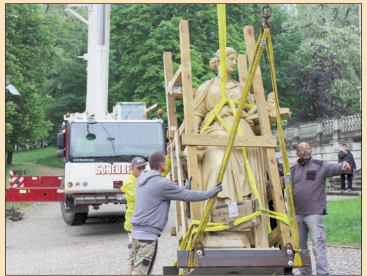
Vorsichtig wird die Muse aufgerichtet und schwebt anschließend am Kranhaken aufs Dach
