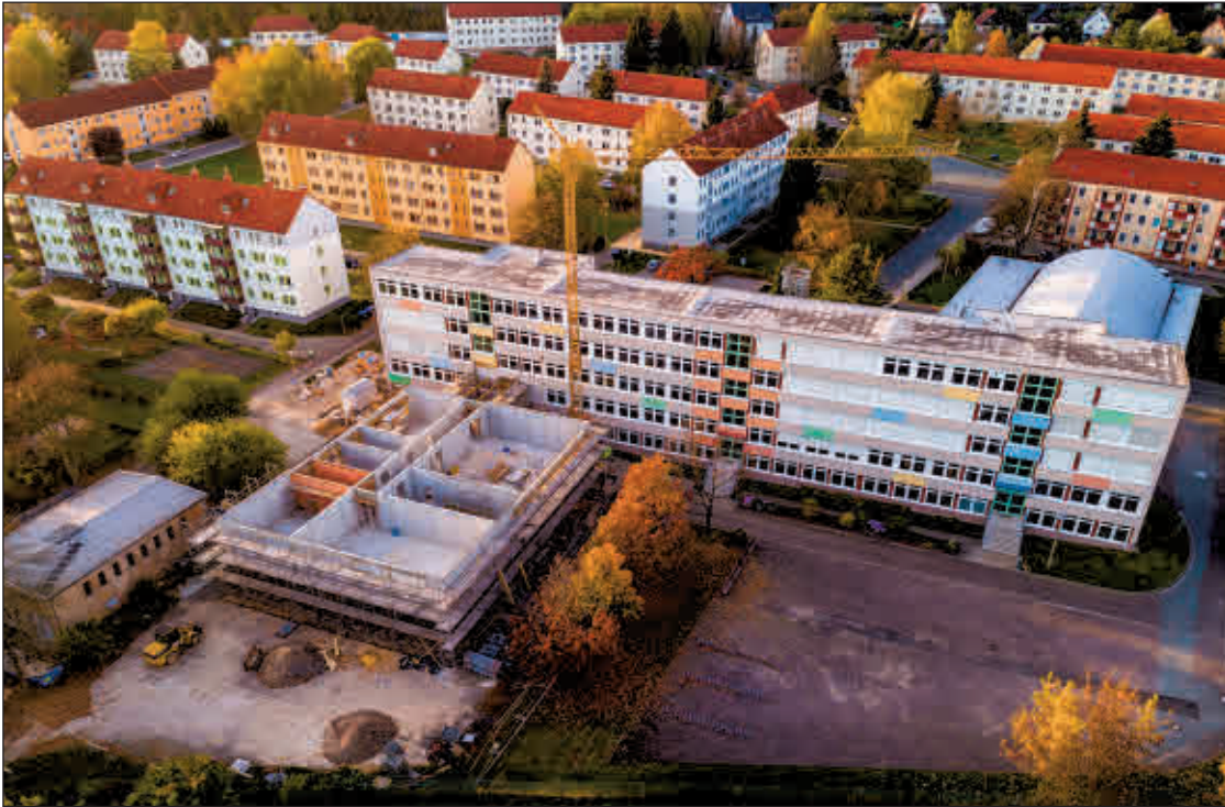
Der Erweiterungsbau des Schmöllner Gymnasiums, hier noch ohne Dach. Die Raumaufteilung ist gut erkennbar. Foto: Flying-picx Schmölln
