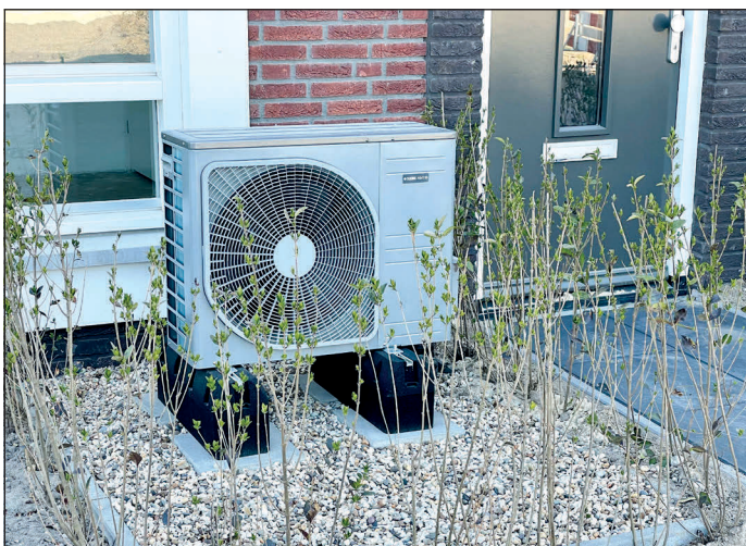
Wärmepumpe vor einem Einfamilienhaus.
