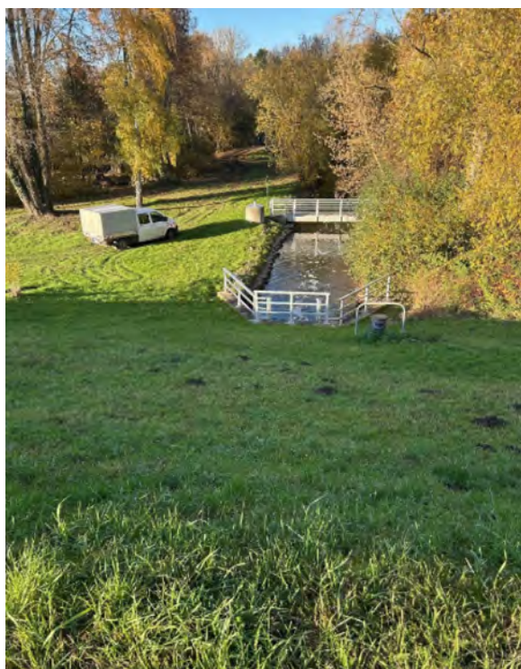
Abbildung 16 Talsperre Windischleuba: luftseitige Dammböschung und Grundablassablauf der Luftseite des Dammes (Foto: R. Pohl)
