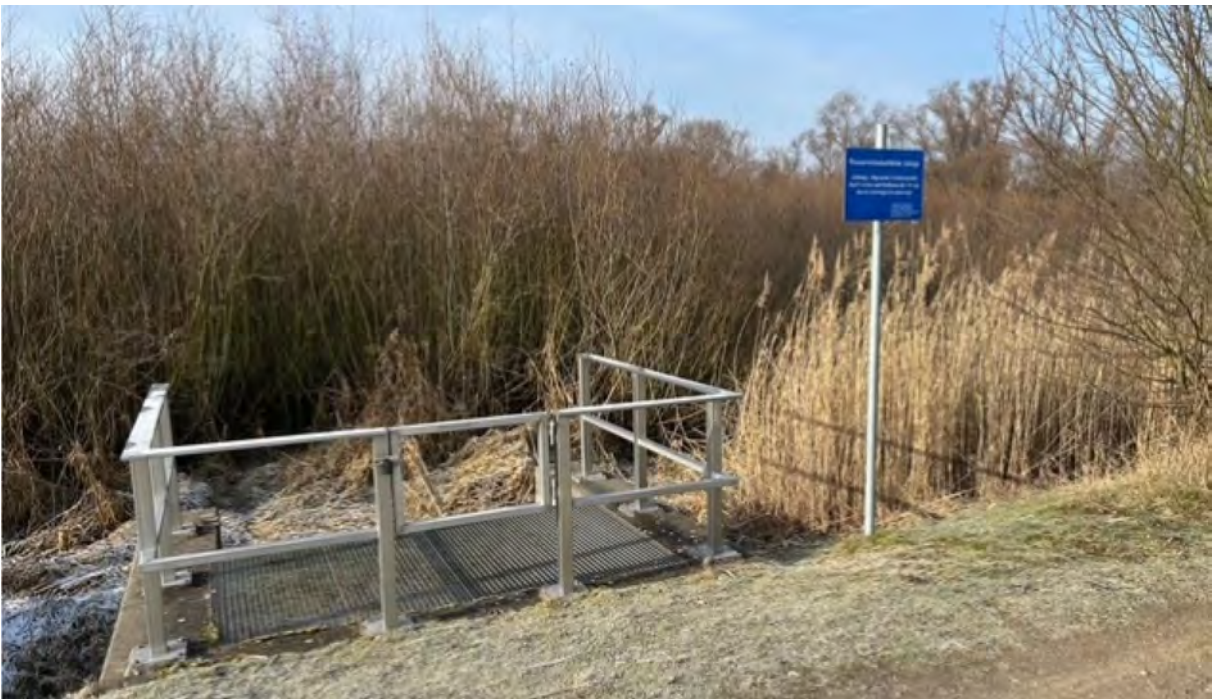
Abbildung 26 Talsperre Windischleuba: dichter Bewuchs und Sediment im Stauraum Trenndamm mit Ausspiegelungsdurchlass linkes und rechtes Vorbecken (Foto: Pohl 2026)
