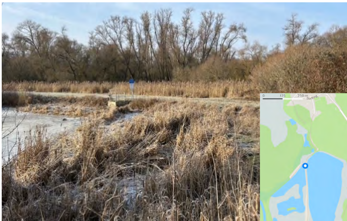
Abbildung 27 Talsperre Windischleuba: dichter Bewuchs und Sediment im Stauraum linkes Vorbecken (Foto: Pohl 2026)
