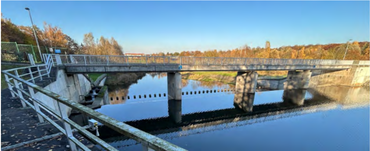
Abbildung 12 Talsperre Windischleuba: Hochwasserentlastungsanlage als feste Wehrschwelle und Tosbecken mit Zahnschwelle. Echolot-Beckenpegel an der Flügelmauer. Oberwasserseitiger Ein-/Ausstieg der Fischtreppe an der linken Wehrwange (Foto: R. Pohl 2025)
